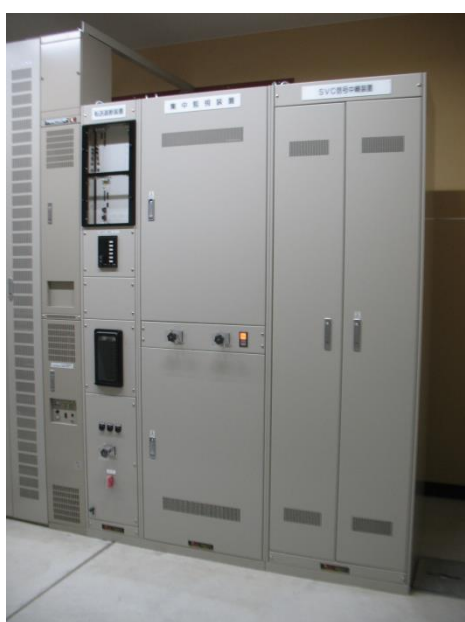
連系変電所 監視装置
