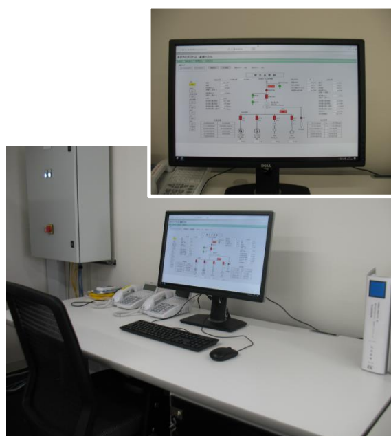
管理棟 監視画面
