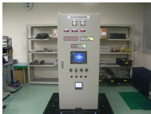
取水口制水門自動制御盤
